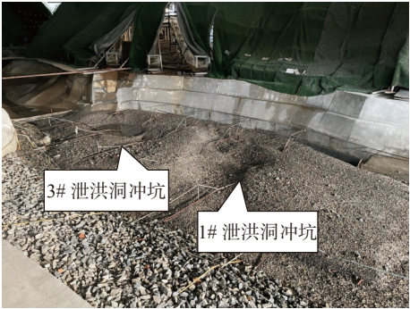
图 6 泄洪洞下游冲坑
