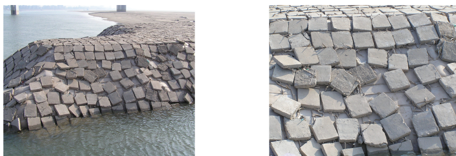
图 5 护滩带系结条断裂、块体脱离排垫的破坏情况
